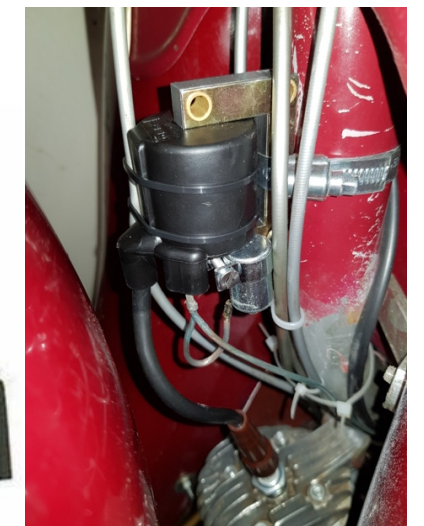
Spole och kondensator monterade
